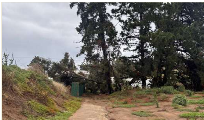
Camino 1 a 2 Sur Grietas y pérdida de superficie
