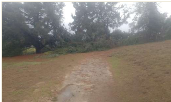
Camino 3 a 4 Sur Arrastre de material y socavón
